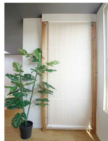
▲エアコンは設置せず、テスク(北海道札幌市)の冷暖房システム「クール暖」を取り付けた
